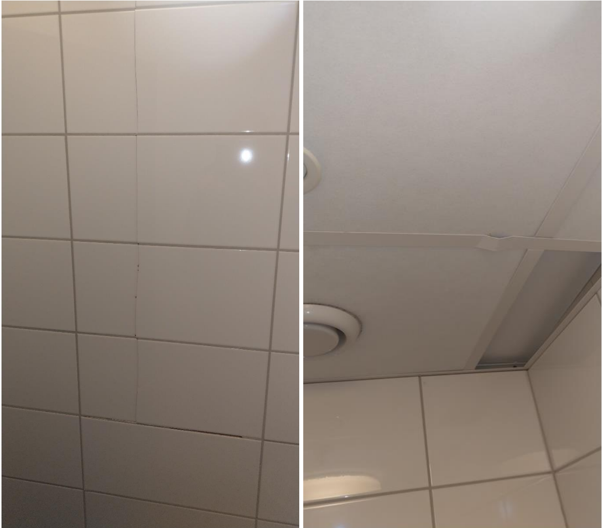
Bilde 3 og 4 Skader fliser bad og himling
