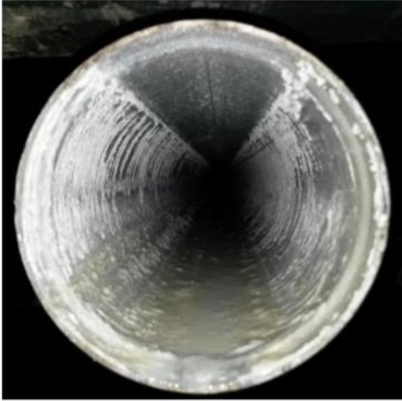
Bilde 4 Forsinket galvanisertrør etter nedtapping på annet anlegg
